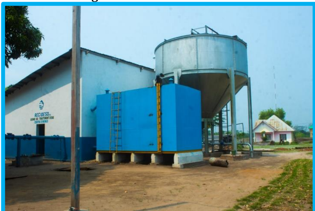
Figure 26 : Vue du Centre de captage de la REGIDESO à Inongo
